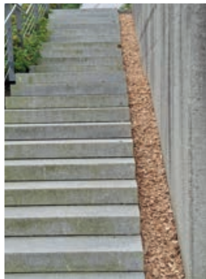
Wegen Vandalismus wurden die Granitsteine entfernt und durch Hackschnitzel ersetzt.
